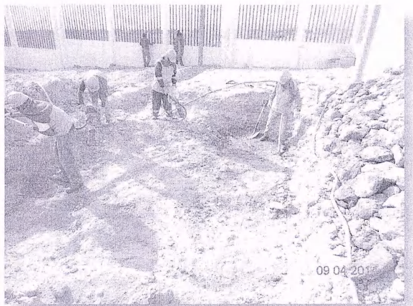
Foto 02. Se muestra la ejecución de la partida de Refine de Terreno Semi Rocoso, empleando 02 martillos Neumáticos
